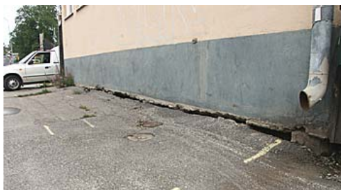
Byggnaden står på Varvsgatan och står stadigt – inga sprickor eller skador syns på byggnaden. Men, marken har sjunkit ordentligt.
